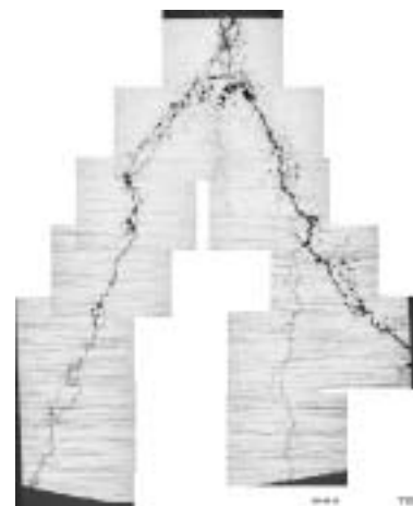
図-1 H4 近傍のひび割れ例 （柏崎刈羽 1 号機 H4）
