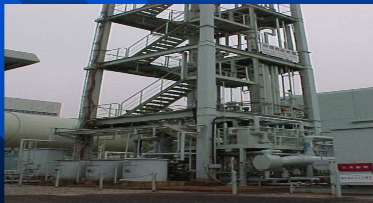
関西電力 南港パイロット機
