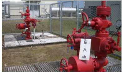
天然ガス貯蔵・再生産
