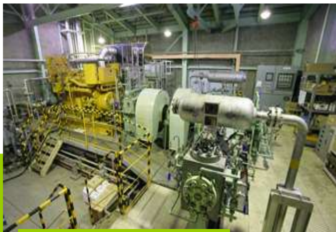
(圧入コンプレッサー)
