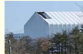
<テント破損状況>
