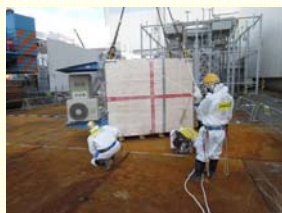
<測定装置設置状況>
