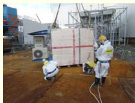
<測定装置設置状況>
