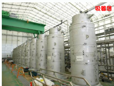
<高性能多核種除去設備 設置状況>
