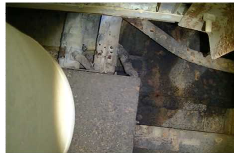
流入箇所下部の写真
