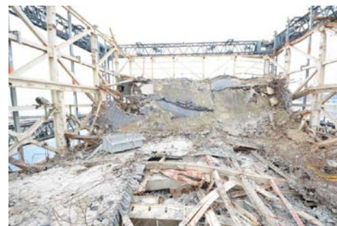
建屋上部のガレキの状況
