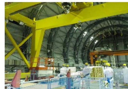
クレーンと燃料取扱機
