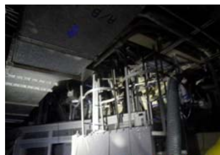
R/B1階上部の状況 (2号機の例)
