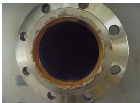
SO型フランジシート面のすき間腐食の様子 『バッチ処理タンク2Aデカントノズル【前頁②箇所】』
