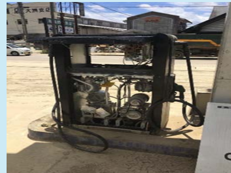
損壊した計量機
