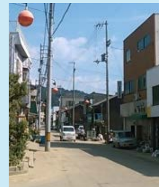
浸水によりカラー 舗装が損傷
