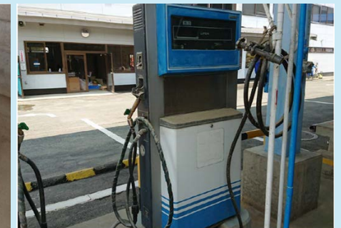
損壊したガスディスペンサー
