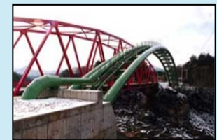
LNGパイプライン
