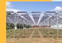
太陽光パネル
