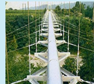
天然ガスパイプライン
