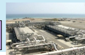
海水淡水化プラント
