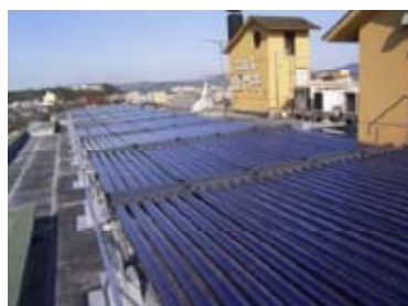
真空管ソーラーシステムの施工例
