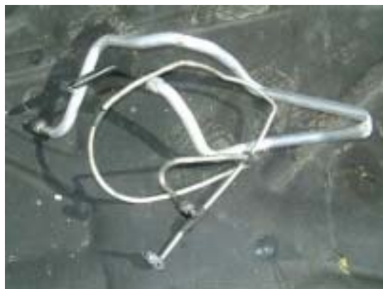
写真3 - 58 その他の配管類
