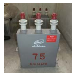
電力用コンデンサー
