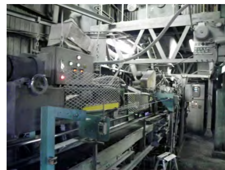
ロープスイッチを設置した装置
