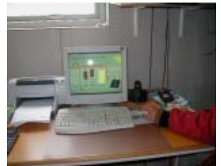
【PCによる熱供給管理】
