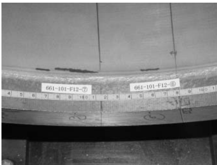
図 4.3-2(b) ひび、 と総合試験範囲の開始点を示す基準線 C1 (基準線 C2 は撮影範囲の左側にある。中央のケガキは切断作業用の補助線である。)
