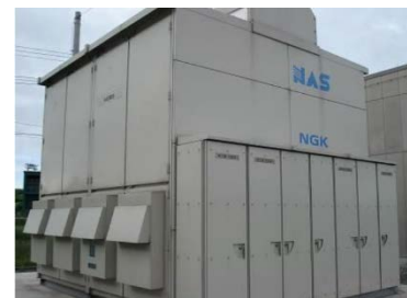
大型蓄電システム施設
