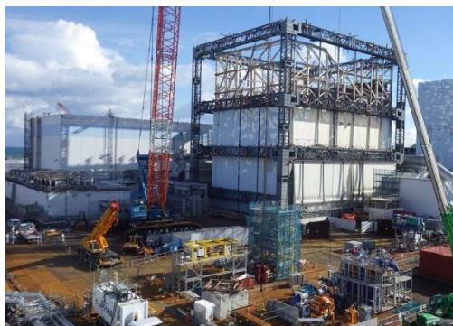
1号機 原子炉建屋の状況
