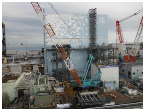
2号機 原子炉建屋の状況
