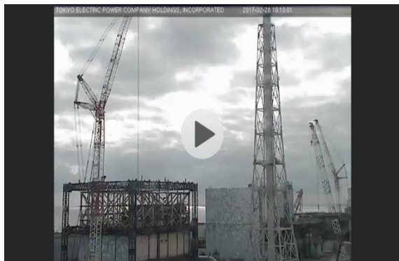
【発電所ライブカメラ映像】
