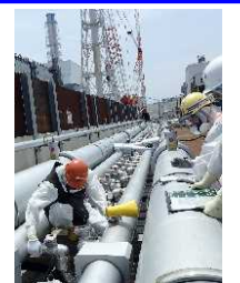
(凍結管バルブ開閉操作の様子)
