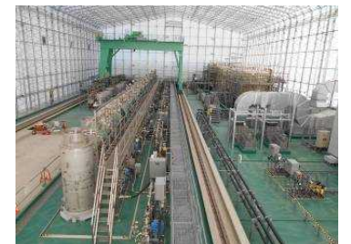
(高性能多核種除去設備)
