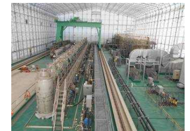
(高性能多核種除去設備)
