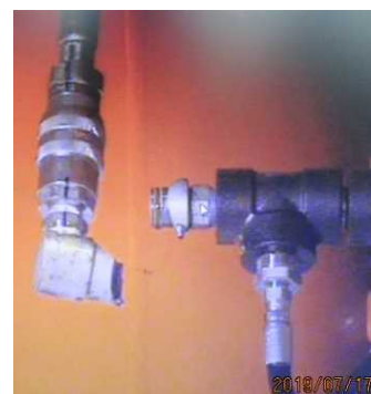
継手破損状況
