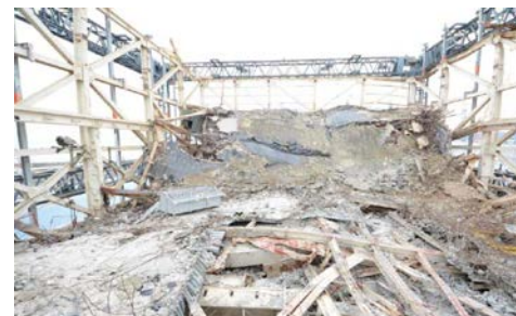
建屋上部のガレキの状況
