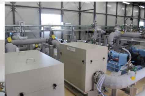
◀ ALPS処理水移送設備 （緊急遮断弁）
