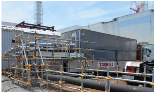
モバイル式処理装置
