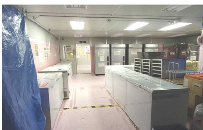
保冷剤冷凍庫の配備
