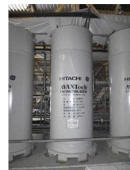
サブドレン等浄化 (吸着塔)
