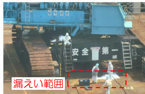
作動油漏えい状況
