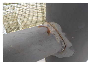
補修前（水平材）
