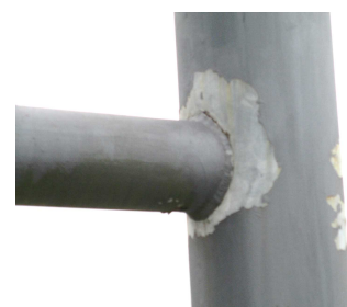
補修前（水平材）
