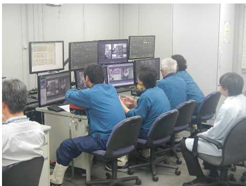
遠隔操作訓練状況写真（遠隔操作室）
