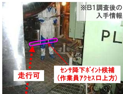
定検時(事故前)の写真(A)
