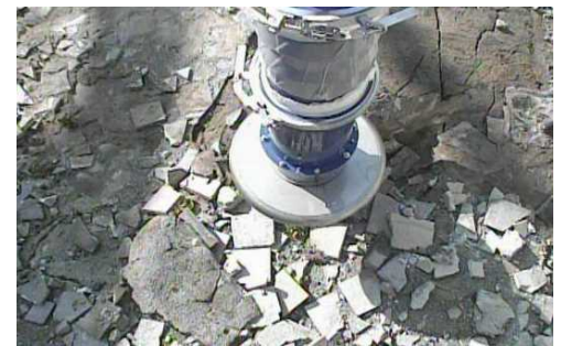
目的外使用・無断複製・転載・開示禁止 東京電力ホールディング 小ガレキ吸引作業中
