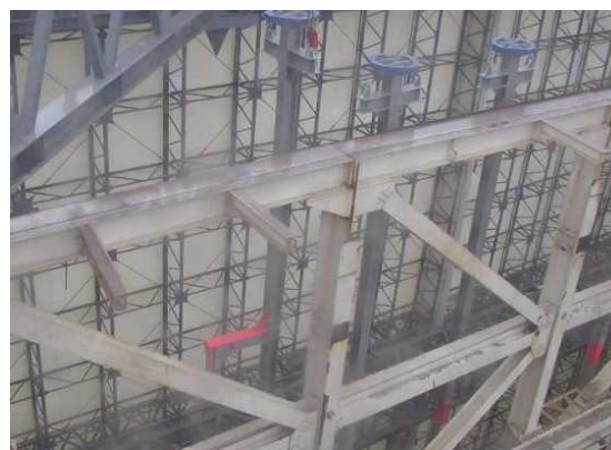
設置状況（東面）
