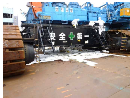
作動油漏えい状況
