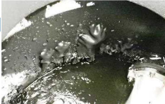
共沈タンク(B)内面の状況 (H29.2) 【ライニングに剥離あり】
