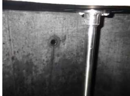
供給タンク(A)内面の状況 (H29.2) 【ライニングに剥離なし】
