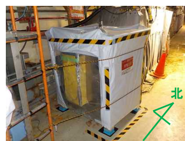
ミュオン測定装置 設置状態 (小型装置, 約1m×1m×高さ1.3m)
