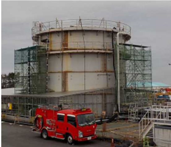
処理水バッファタンク外観
