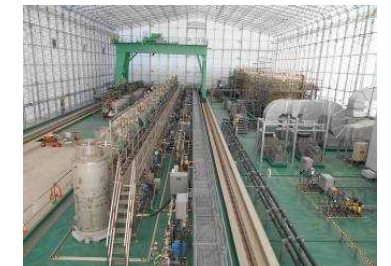
(高性能多核種除去設備)
