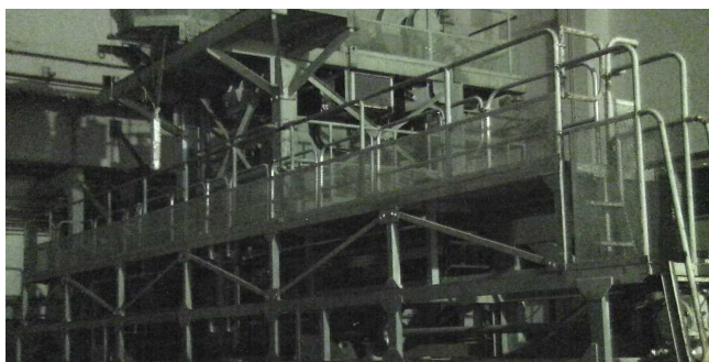
① 【燃料取扱機】
