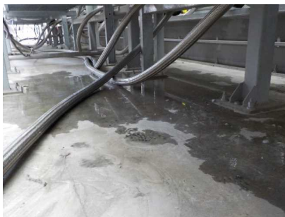
漏えいの状況
