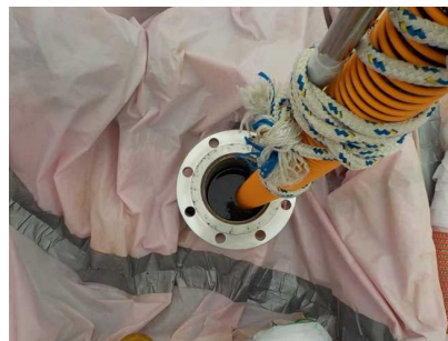
吸着塔3C 点検口
