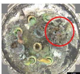
②接続部内部 (リード線切断後)
