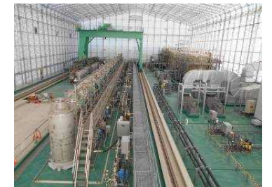
(高性能多核種除去設備)
