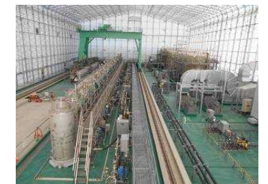
(高性能多核種除去設備)
