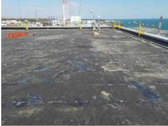
2R/B上屋対策状況
