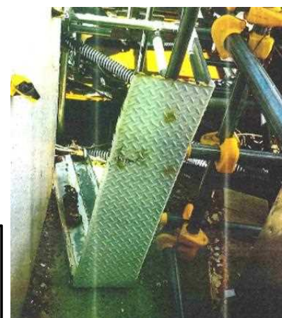
落下した点検用の足場
