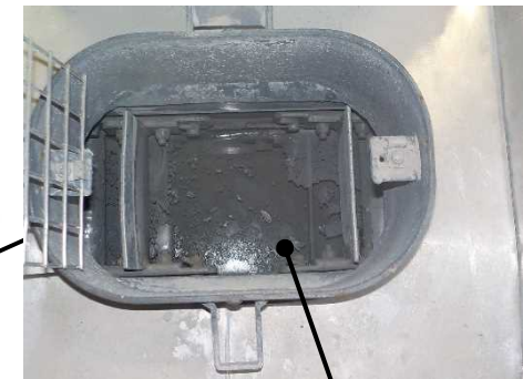
灰搬送コンベア内残水
