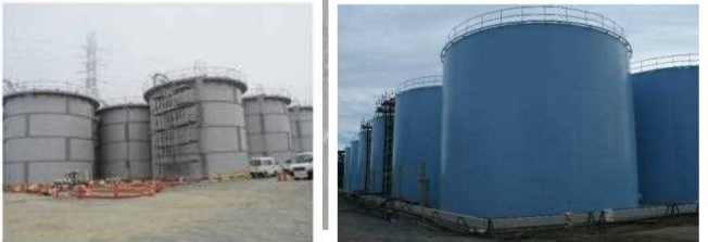
タンクの設置状況
